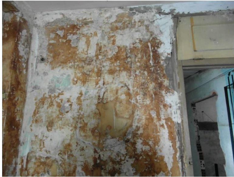
Foto 26. Pared con la superficie deteriorada, ex CCDTyE Automotores Orletti. Foto tomada el 3 de agosto de 2016
