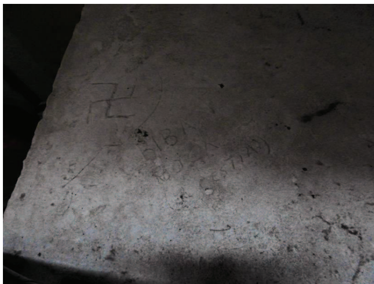
Foto 28. Incisiones en el revoque de un techo, ex CCDTyE Virrey Cevallos. Fotografía tomada el 25 de julio de 2014
