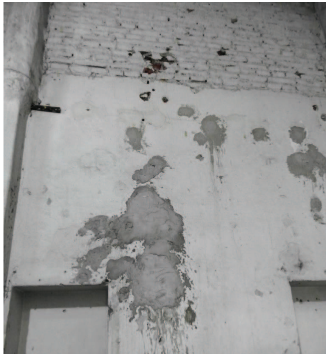
Foto 13. Impactos de bala visibles y tapados con cemento, ex CCDTyE Automotores Orletti. Foto tomada el 3 de agosto de 2016
