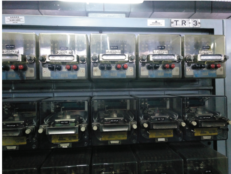
Figura 2. Relés relevadores de equipos de campo (Plaza Constitución, 2018).
