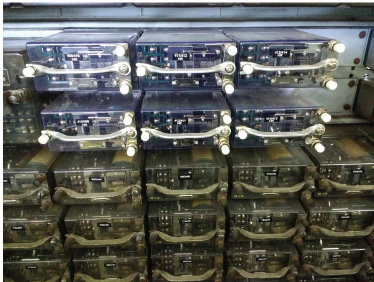
Figura 1. Relés de enclavamiento ferroviario (Plaza Constitución, 2018).
