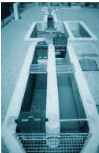
Figura N° 34. Desarenador de doble canal. Fuente. (CENTA, 2008)
