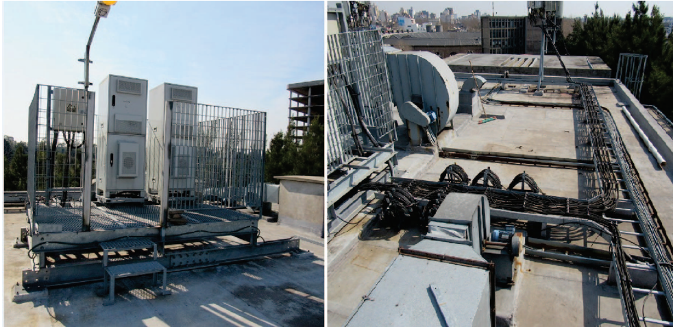
Figura 6.17: Cabina de transmisión alimentación y baterías
