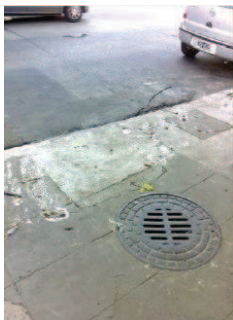
Figura 5-24. Boca de registro. Recuperado de Scherdtfeger, 2019.
