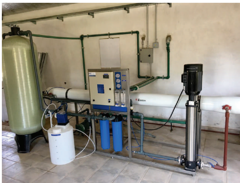
Figura 5.16: Sistema de tratamiento de agua por Ósmosis Inversa con capacidad de 3.300 L/h. Fuente: Faisan.
