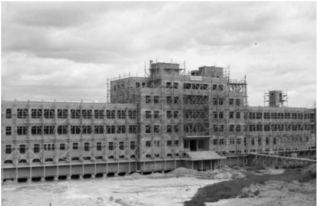
Imagen 42. Construcción de la Cámara de Apelaciones, en la parte superior y central se ubica letrero con la leyenda PERON CUMPLE, Comodoro Rivadavia, 1951 aproximadamente.
