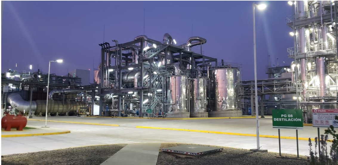
Figura 9. Equipamiento de separación y evaporación de sólidos, se puede divisar la secadora a la izquierda alimentada con gas natural. Fuente: Foto propia.
