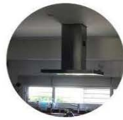
Extractor purificación de cocina, de acero inoxidable sobre cielorraso de yeso. Panel led blanco con luz neutral embutido en cielorraso
