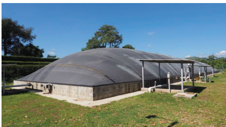
Figura 17: Laguna anaeróbica con membrana para gestión de gases (Fuente: www.en-aqualimpia.com/why-aqualimpia/ )
