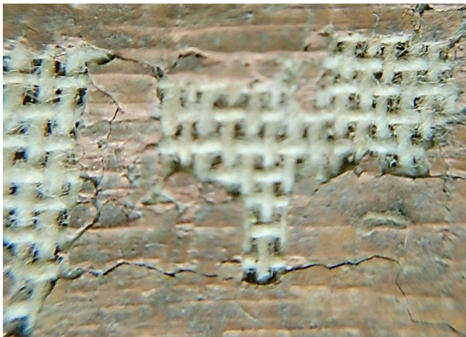
Fig. 42: Detalle de los faltantes de capa pictórica y de preparación. Trama de la tela expuesta.
