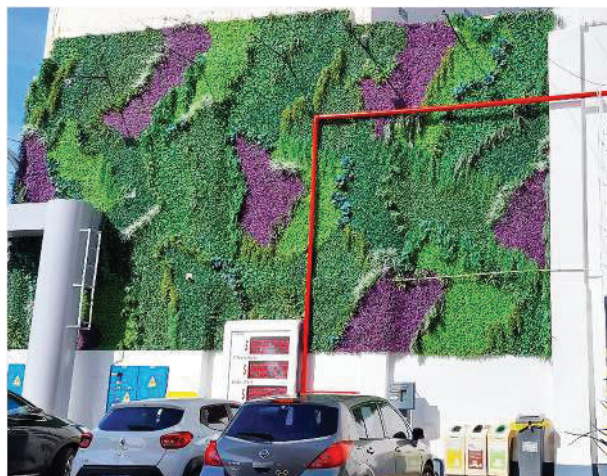
Figura 68. Fachada verde sobre el muro de la estación de servicio Shell ubicada en la intersección de las Av. del Libertador y Comodoro Martín Rivadavia, CABA.
