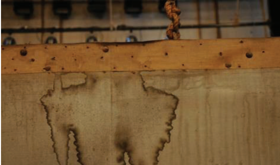
Figura 49: Marcas de chorreaduras de agua en la parte superior del telón.
