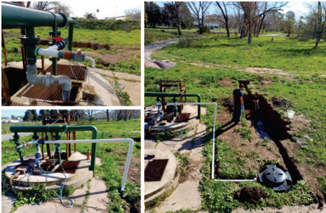
Figura V.12. Desvío del efluente cloacal hacia el tanque séptico.
