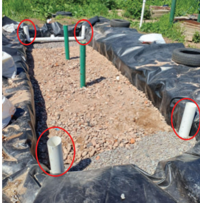
Figura 6. Humedal domiciliario, se marcan en rojo cámaras de inspección y limpieza de las estructuras de entrada y salida
