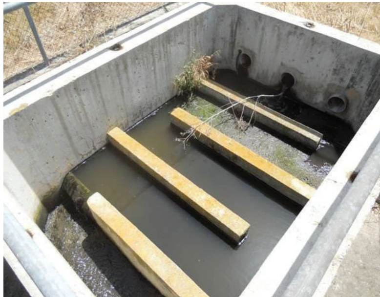
Figura 15 : Fotografía de una cámara de cloración. Fuente: Google imágenes.
