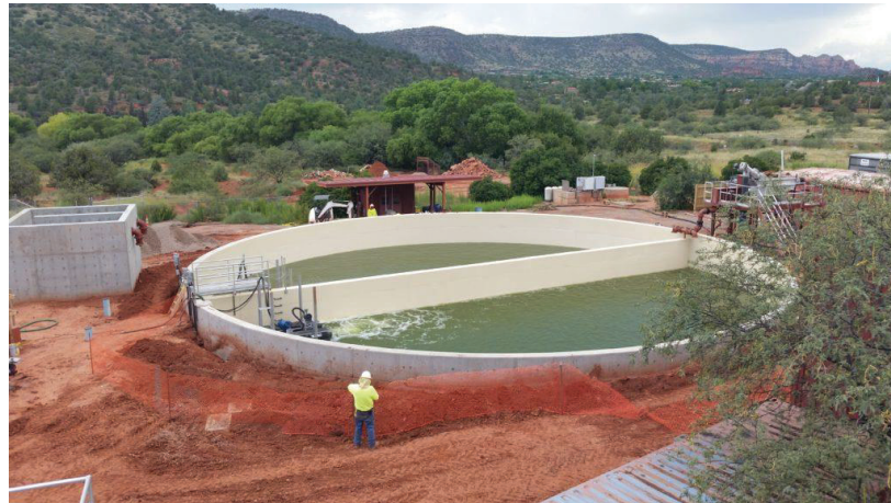
Figura 11: Tanque de ecualización. Fuente: Google imágenes.
