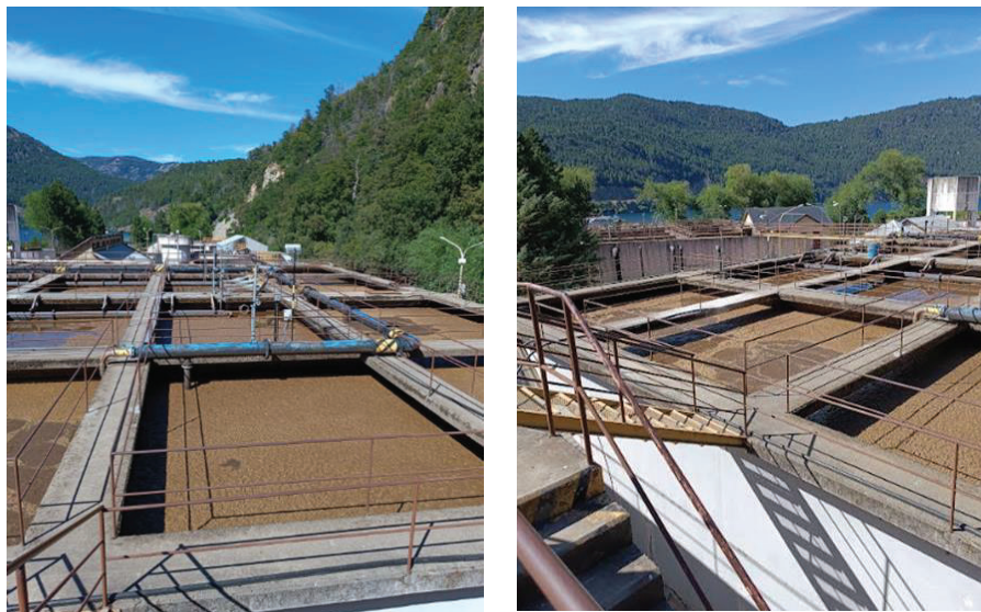
Figura 51: Reactor biológico de la planta depuradora de San Martín de los Andes
