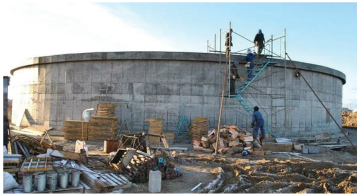
Figura 57: Cisterna ubicada en el Margen sur de la ciudad de Río Grande. Fuente: (Del fuego noticias, 2012)
